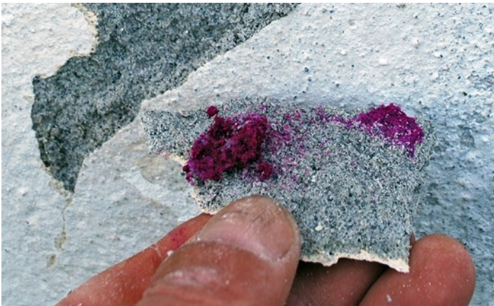
Noen dråper av kjemikaliet fenolftalein indikerer at den nye kalkpussen ikke er herdet/karbonatisert, her selv etter flere år. Dette betyr at pussen er følsom for frost. Årsaken er først og fremst for fuktige forhold og manglende tildekking første vinter etter påføring.
