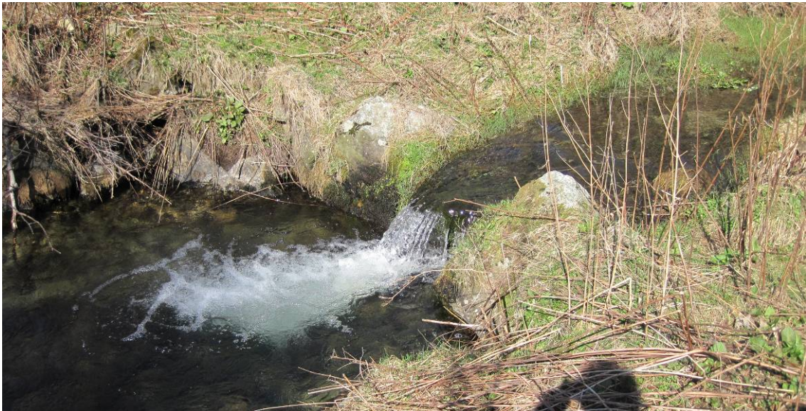
Figur 19: To terskler i nedre del av bekken medfører ulemper for fiskevandring og bør fjernes
