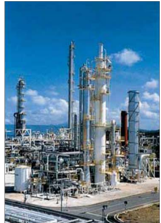
CO 2 -fangst fra mindre anlegg i Malaysia
