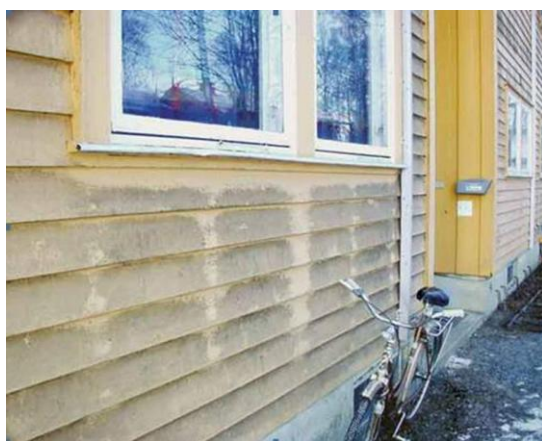
Bilde 5.1: Svortesopp kan forekomme p.g.a. dårligere uttørking ved temperatursenkning på yttervegg. (Byggforsk)
