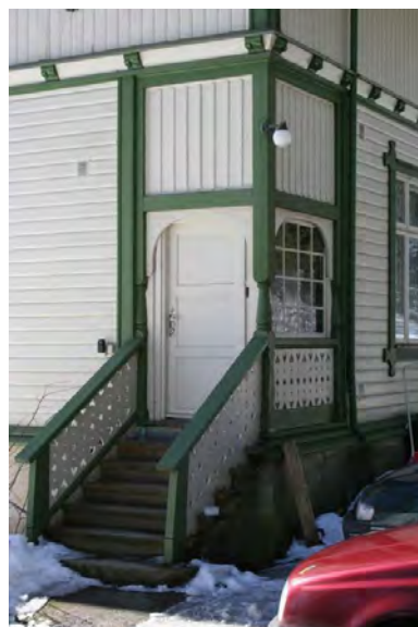
Bislaget ved kjøkkeninngangen i nordøst var opprinnelig åpent uten dør og vindu. Opphavsrett: NIKU.
