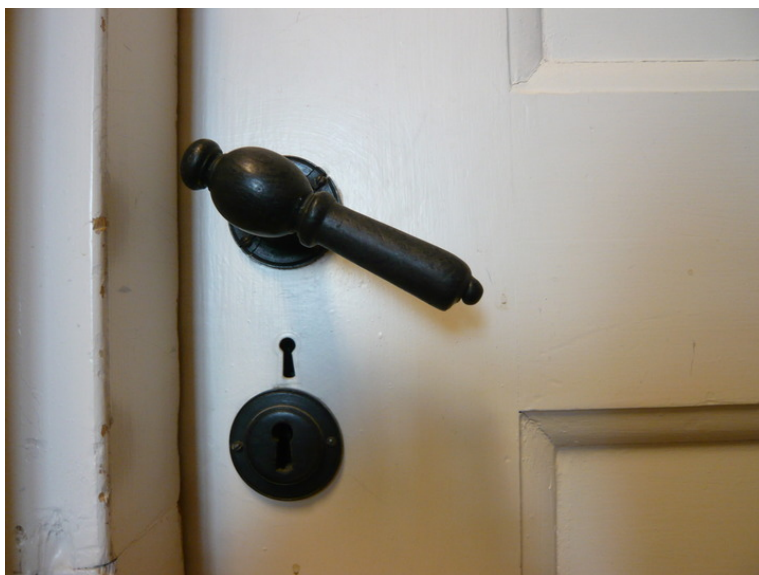
Opprinnelige dørvidere fortsatt i bruk. Opphavsrett: Statsbygg.
