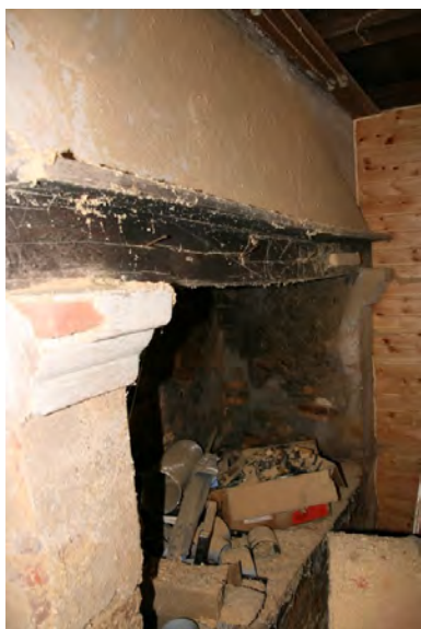
Grue i bryggerhus. Opphavsrett: Statsbygg.
