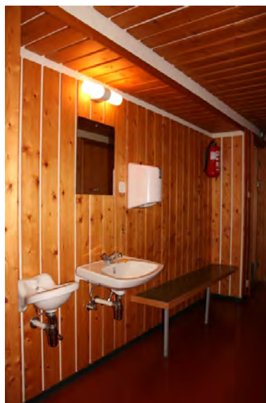
Vask og drikkefontene i korridor. Opphavsrett: Statsbygg.
