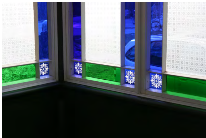
Vinduene i glassverandaen er av nyere dato. Opphavsrett: Statsbygg.
