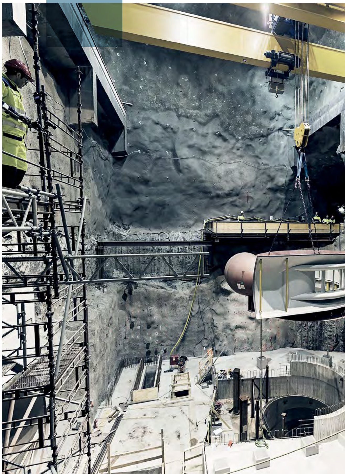
Ny Iveland spiraltrommel. Foto: Agder Energi
