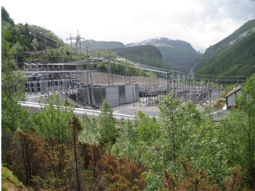
Bilete syner Børdalen trafostasjon.
