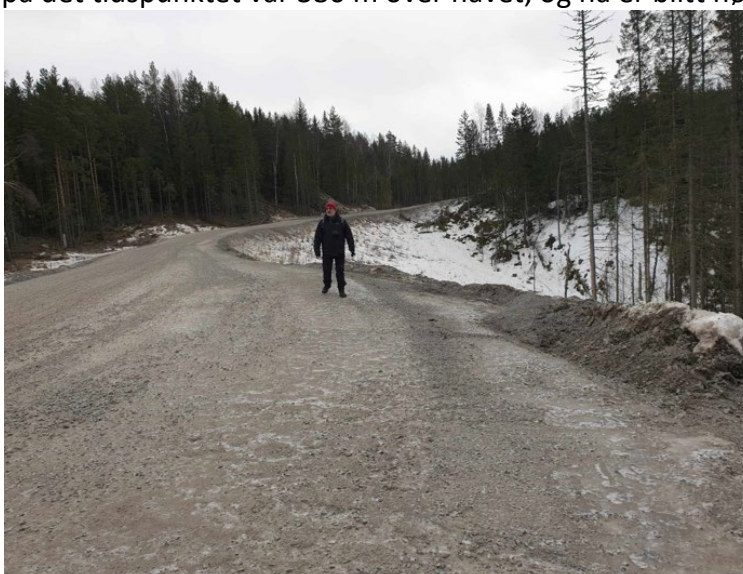
«Turveien» til Marikollen er et inngrep som stedvis er 20 meter bredt. Foto: ØV
