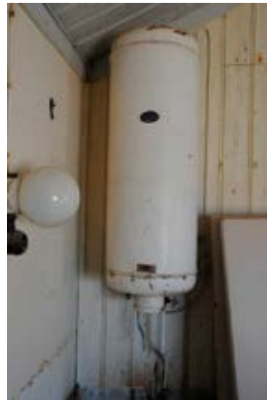
Varmtvannsbereider i hovedrom (øst).
