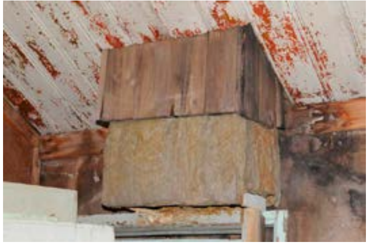
Ventilasjonskanal/lyre i hovedrom (øst)
