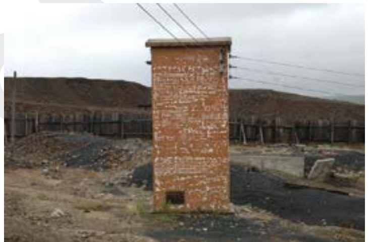
Trafokiosken stt fra nord Foto: Jon Holm Lillegjelten
