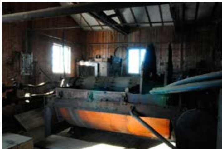
Tøketrommel, 2. etg i flotasjonen.
