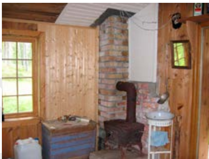
Ildstedet er montert mot yttervegg. Bildet er tatt mot øst. Foto: Einar Engen Opphavsrett: Statsbygg
