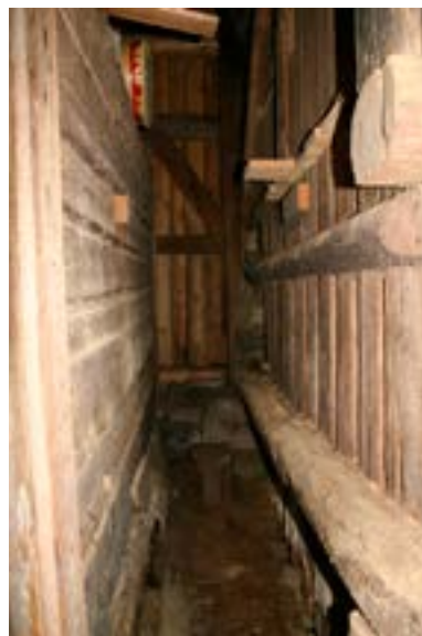
Mellom to laftekasser i driftsbygningen Foto: Monica A. Rusten Opphavsrett: Monica A. Rusten©Riksantikvaren
