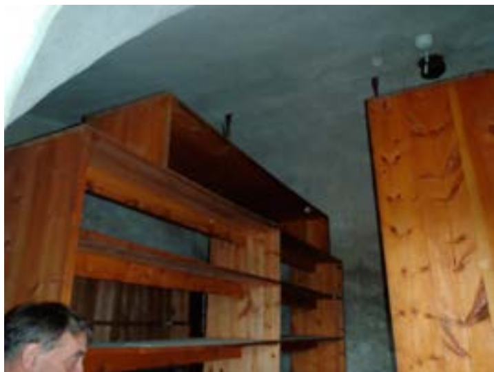
Pussede vegger og hvelving. Foto: M.Oftedal, Forsvarsbygg.
