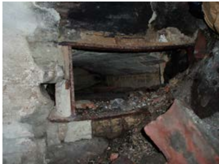
Bakerovnen på kjøkkenet. Foto: Sveinung Råheim Opphavsrett: Fylkesmannen i Nordland
