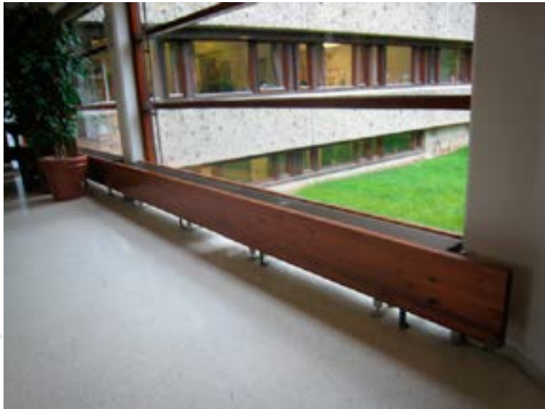
Radiatorskjuler Foto: Eirik T. Bøe
