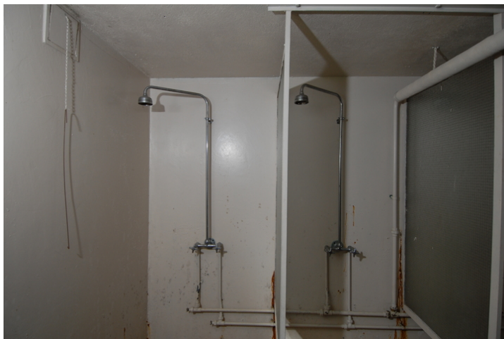
Vaskerom kjeller. Foto: Leif Anker, Forsvarsbygg.
