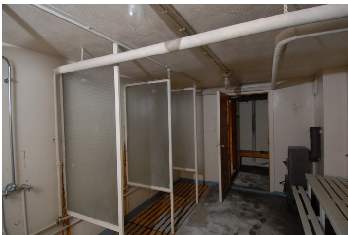
Vaskerom kjeller. Foto: Leif Anker, Forsvarsbygg.
