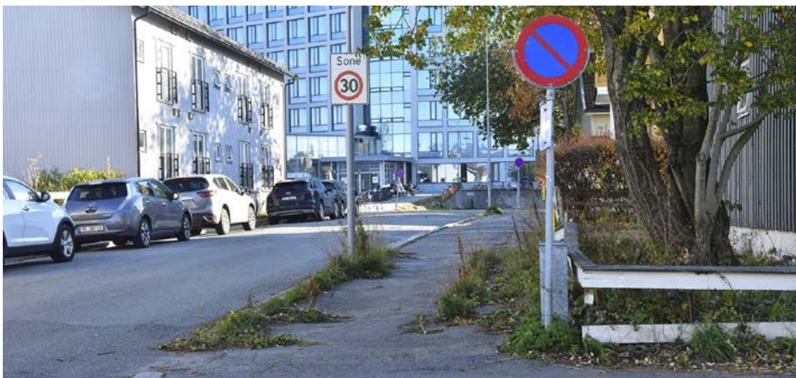
Nedslitt fortau ved Nordlandssykehuset.
