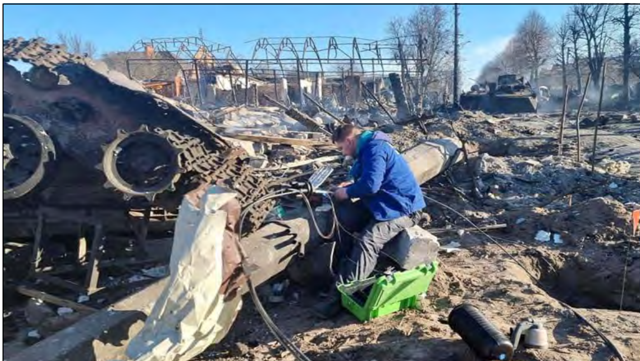
Figur 3.7 Krigen i Ukraina viser at den sivile understøttelsen av forsvarsevnen gjennom hele krise- og konfliktspekeret må være robust og effektiv. Her arbeider en ukrainsk telekommunikasjonsmontør med å reparere og gjenopprette kritisk kommunikasjonsinfrastruktur.
