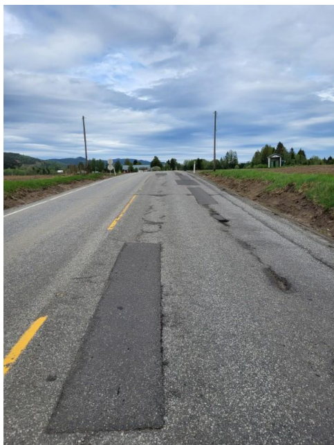
Foto: Skader i asfaltdekke
