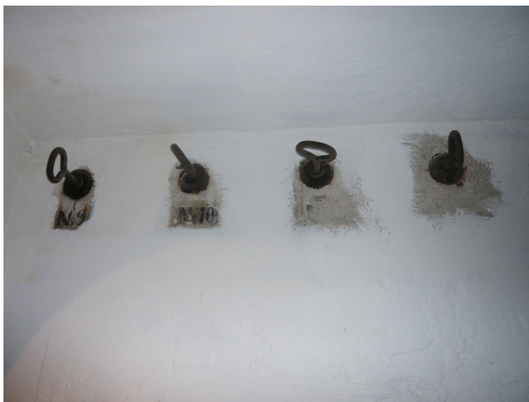
Spjel til hver celle. Del av opprinnelig oppvarmingssystem. Opphavsrett: Statsbygg.
