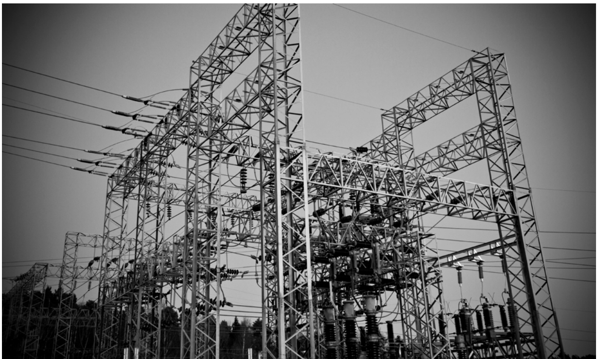
Trafostasjon ved Abildsø, Oslo. Foto: Espen Bratlie/Samfoto.
