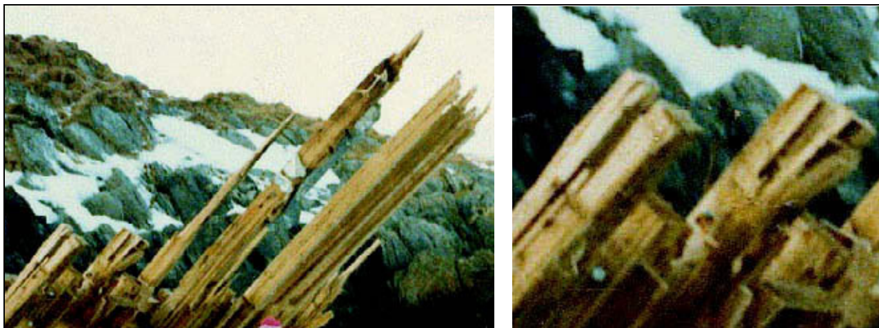
Figur: 7.14 Brudd i dekkbjelker over motorrom.
