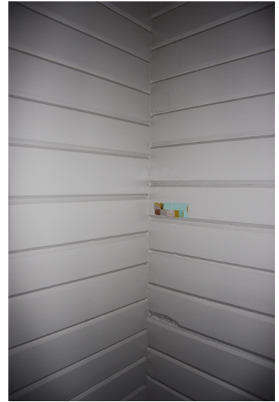
Panel fra 1860-årene illuderer laft. Opphavsrett: Statsbygg.
