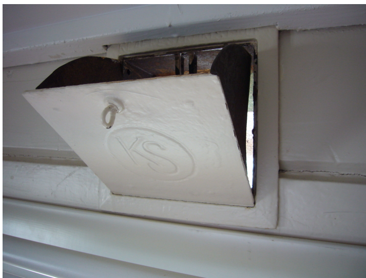
Lufteluke. Opphavsrett: Statsbygg.
