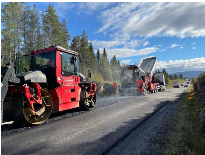
Figur 1.10 Statens vegvesen og NTNU har inngått et samarbeid for å bidra til en karbonnøytral og bærekraftig veisektor i Norge innen 2050. Her legges det ny, klimavennlig asfalt på E14 i Meråker. Foto: Ellinor Hansen.
