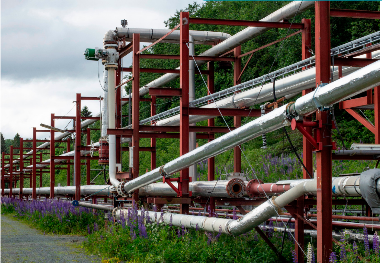
Tiller, Trondheim. SINTEF sitt laboratorium for forskning på fleirfase rørtransport for petroleumsindustrien.
