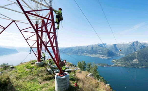
Foto: Statnett SF
