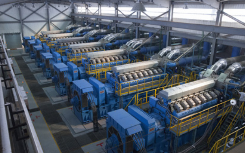
Generatorer fra Bergen Engines dekker nå ca. fem prosent av Bangladesh' elektrisitetsforsyning. Disse er installert i Chattogram. (Foto: Bergen Engines)
