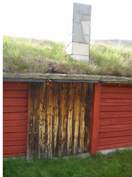
Detalj av mellomparti i bindingsverk og uheldig pipeløsning Foto: Trude Norddal Opphavsrett: Statsbygg
