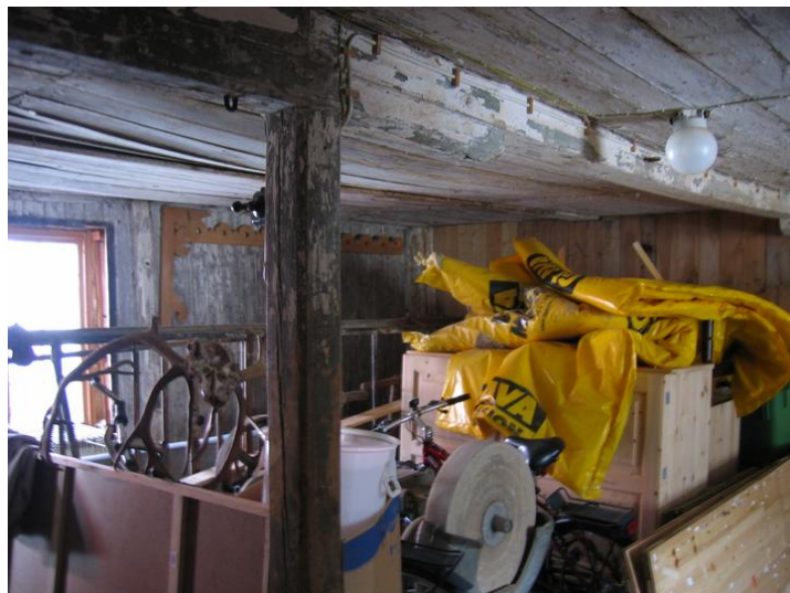
Fuktskader i taket Foto: Trude Norddal Opphavsrett: Statsbygg
