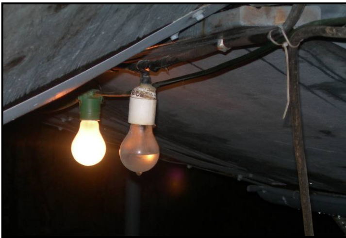
I Nordre galleri på Vaterholmen – som på flere andre fjellanlegg, er det problemer knyttet til vanngjennomgang. (Foto: NFV 2007)
