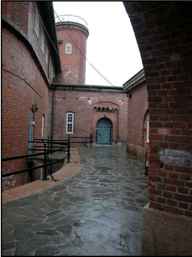
Fortet Norske Løve på Karljohansvern er vurdert til TG 2. Et gjennomgående problem er bruk av for tette puss- og malingsbehandlinger innvendig og sementmørtel i fuger utvendig. (Foto: Schrumpf 2005).
