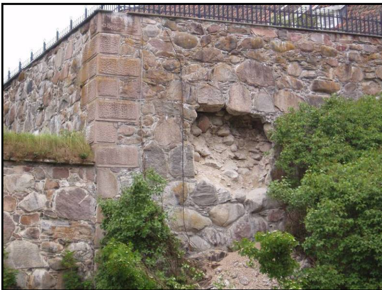
Bilde fra utrasing på Gyldenløves batteri (jf. forsiden). Restaurering ble igangsatt i 2007 og skal slutføres i 2008. Det har vært nødvendig å grave ut all jordmasse i bakkant og ta ned hele muren i skadeområdet, før gjenoppbygging og tilbakefylling kunne påbegynne. (Foto: Ukjent)
