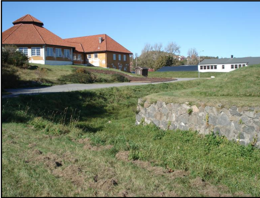
Murene på Fredriksvern er ustabile og det er behov for vegetasjonsrensning. (Foto: Mur-Sentret AS 2007)
