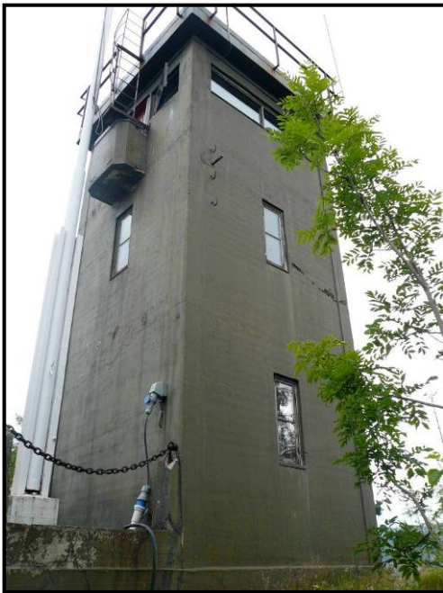
Kongen er utkikkstårnet på Søndre Kaholmen og den eneste bygningen i funksjonalistisk formspråk på Oscarsborg. Tårnet med splittflagget hengende på flaggstangen er symbolet på kommandantskapet. Vurdert til TG 2 fordi utbedring må gjøres for at forfallet ikke skal akselerere. (Foto: Arkitektskap 2007)
