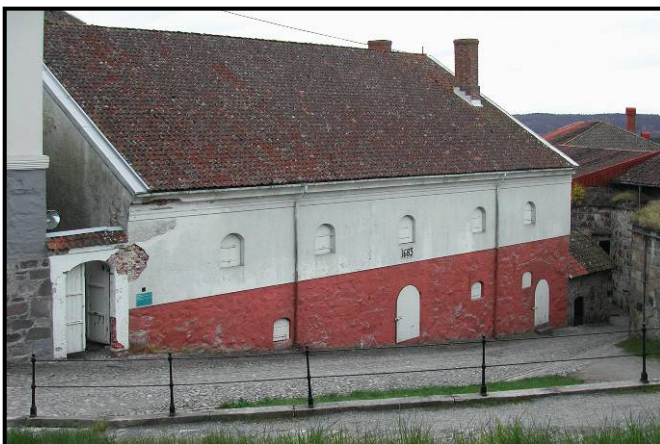
Nedre magasin er vurdert til TG 3 blant annet på grunn av dårlig fasadepuss, som også faller ned som store biter i festningsgaten. (Foto: Neubert)
