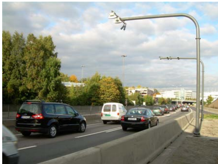
Eksempel på et AutoPASS punkt
