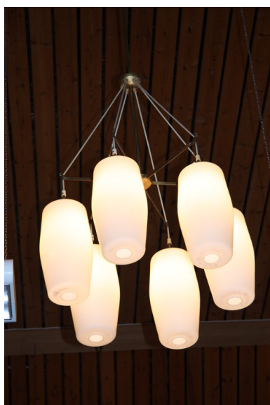
Originale lamper i aula. Opphavsrett: Statsbygg.
