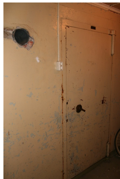
Hvelvdør i kjeller. Opphavsrett: Statsbygg
