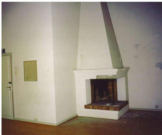
Maling og puss flakker av fra veggene i nedre tårnrom. Foto: Siri Hoem Opphavsrett: Oslo kommune, Byantikvaren
