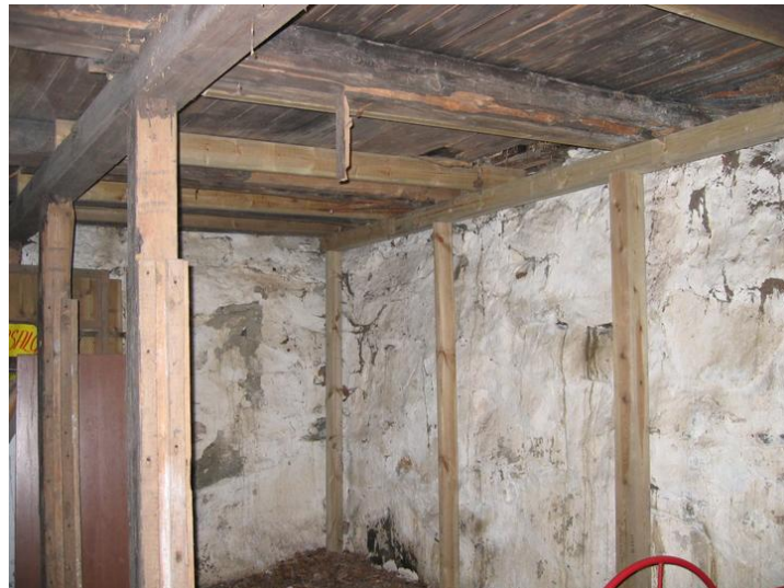
Potetkjellerens gulv er støttet opp med stendere. Foto: Lasse Kaas Opphavsrett: Statsbygg
