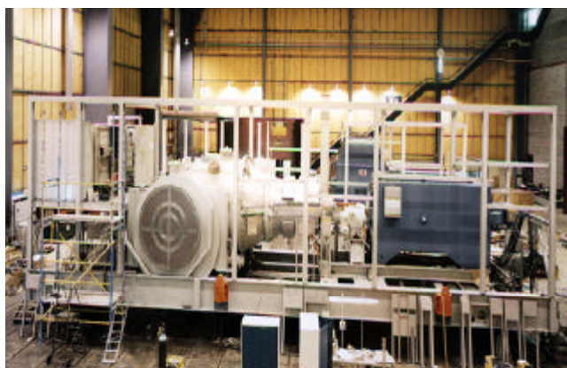
Figur 14 Kombinerte kraftanlegg (Kilde Norsk Hydro)
