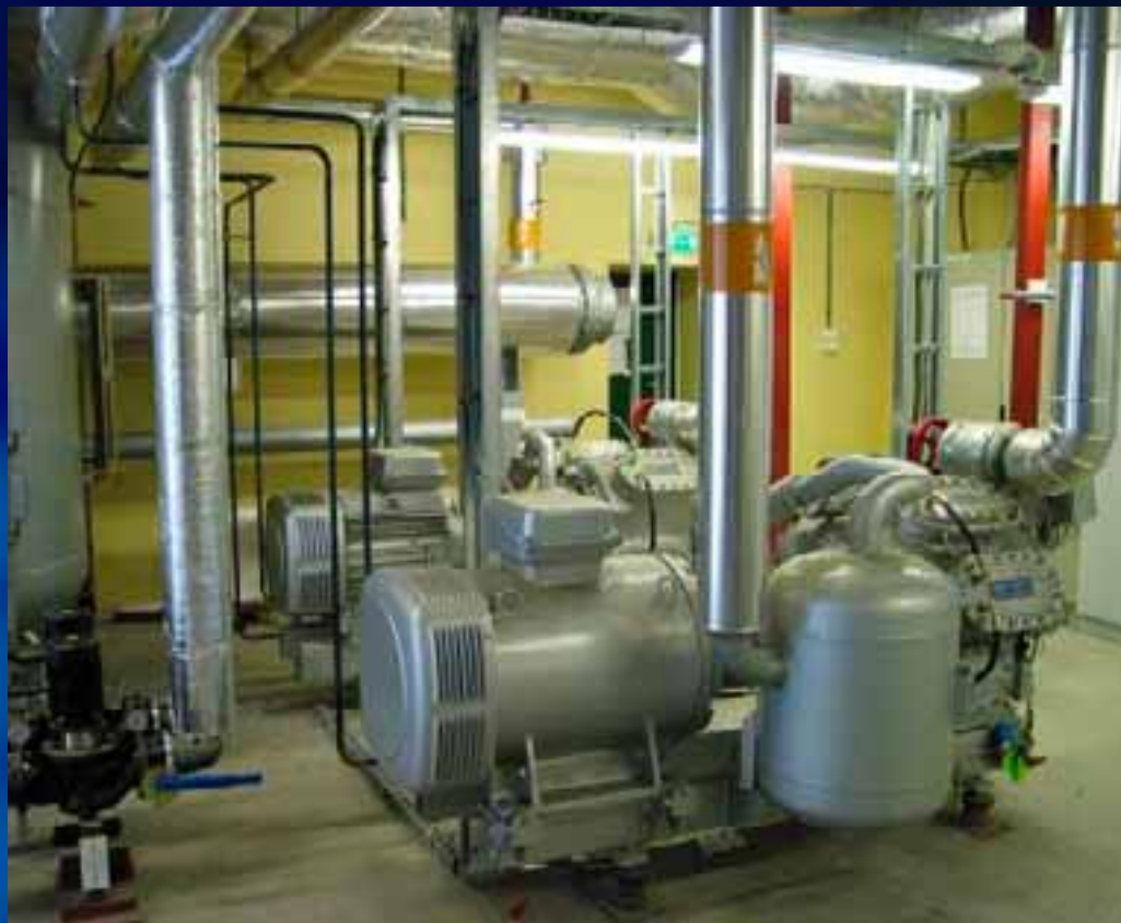
Marienlyst kunstisbane, energisentral med varmepumpe og nærvarmenett
