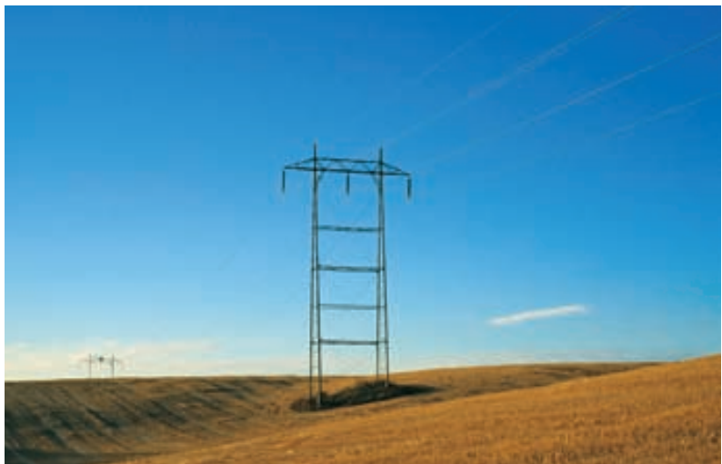
Photo: Trond Isaksen, Statnett
