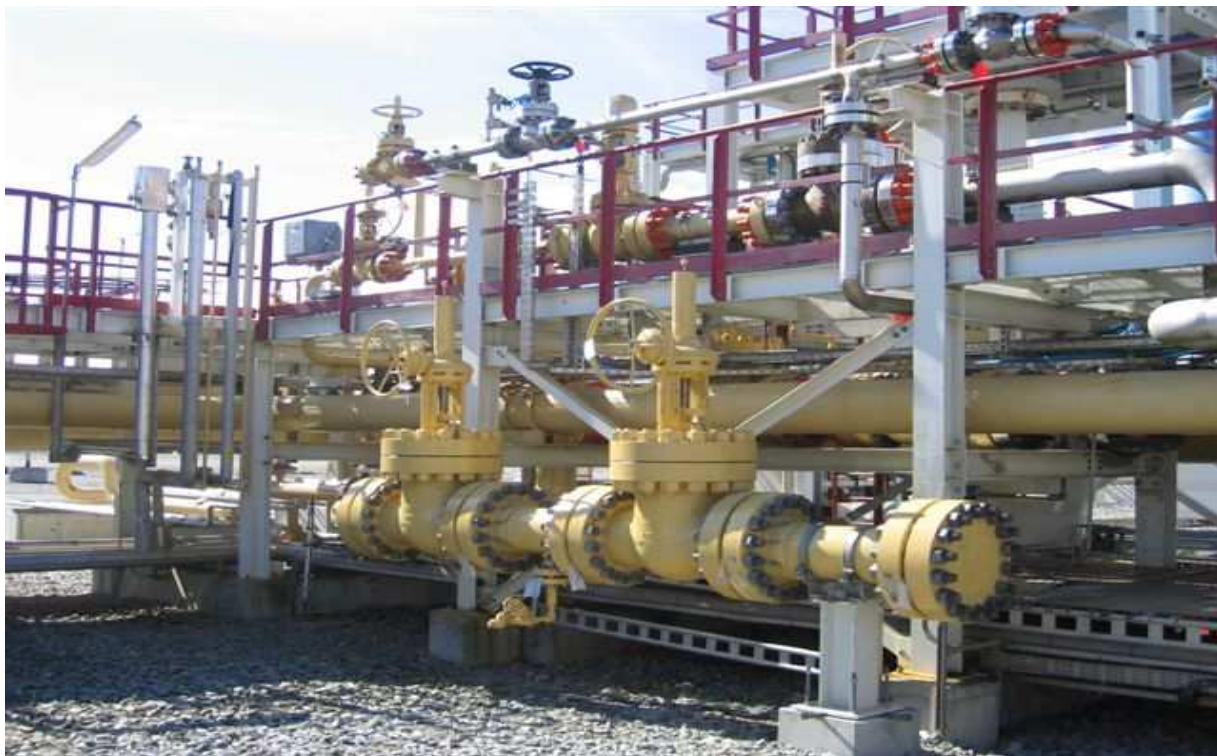
Figur 4-2. Ventiler på Kårstø gassbehandlingsanlegg klargjort for Skanled
